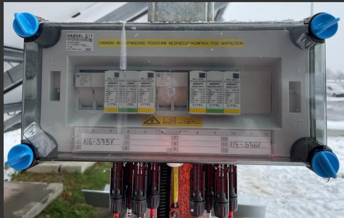
Zdjęcie rozdzielnicy DC
