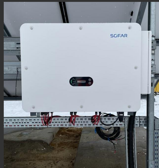
Zdjęcie inwertera fotowoltaicznego
