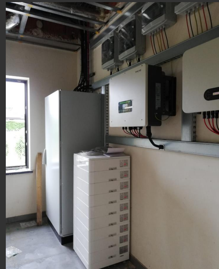
Zdjęcie magazynu energii oraz inwerterów fotowoltaicznych
